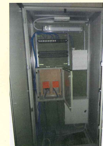
Figura 7.7. Registro principal de la red de cables de pares en el interior del RITI.
