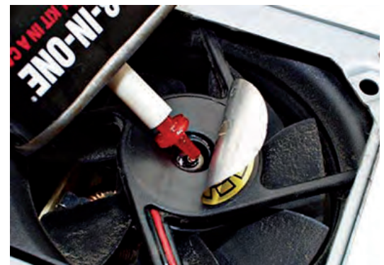
↑ Lubricación de uno de los ventiladores del equipo.
