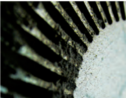
↑ Ventilador con exceso de polvo.
