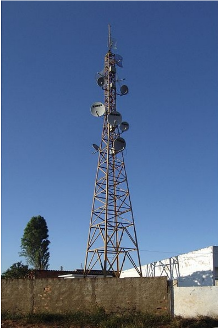
FIGURA 4.13: TORRE DE TELECOMUNICACIONES DE LLUTXENT.
